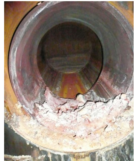
Kesselschaden durch Kalk.
